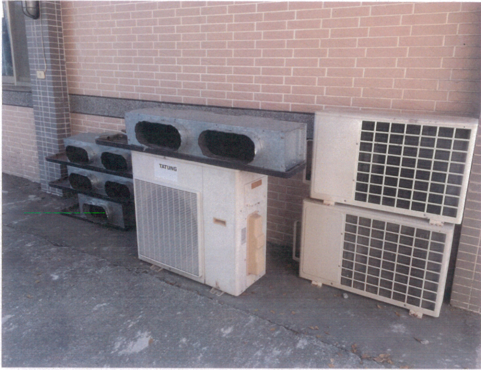
吊隱式冷氣 3 台
