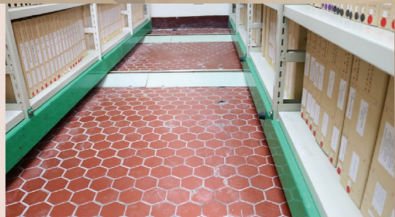
· 地面龜裂凹陷，檔案櫃軌道變形
